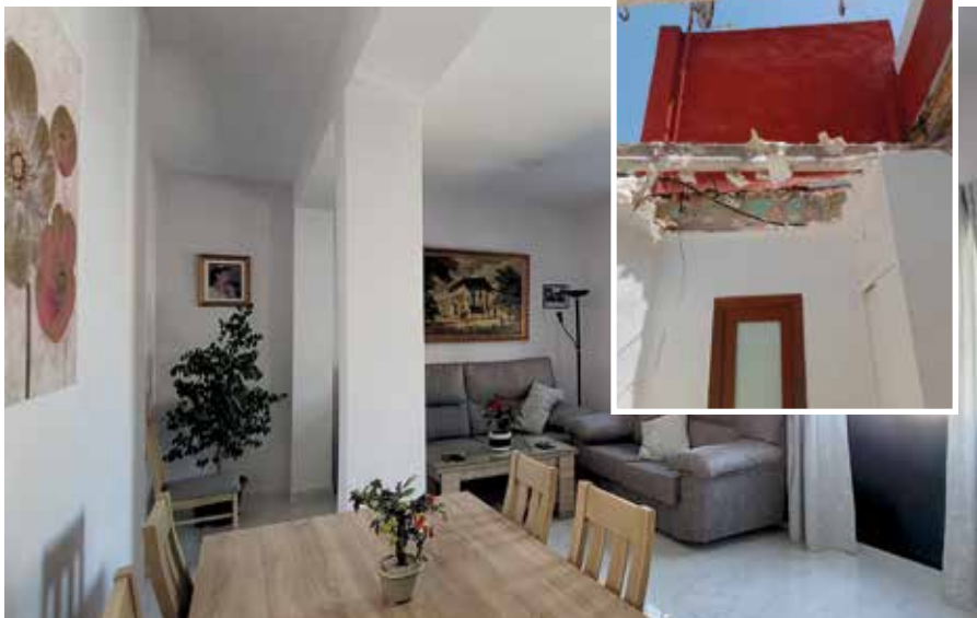
Vivienda reformada en Jerez de la Frontera (abajo), tras derrumbarse el techo un año antes (arriba).
